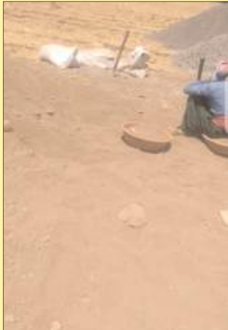
आस-पास के नालों से लाया गया घटिया गारा युक्त बन्टा जिससे किया जा रहा है सीसी रोड का निर्माण
